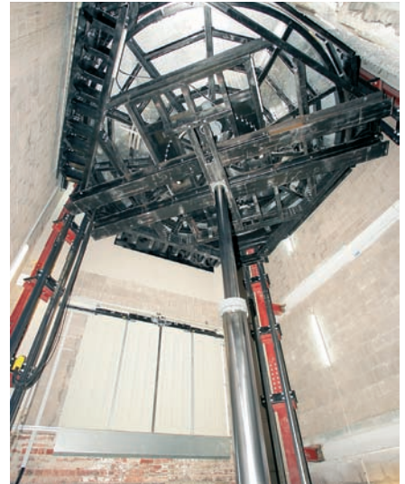
Schachtansicht mit Hydraulik
